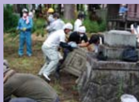
崩れた灯籠を運搬（兵庫）
